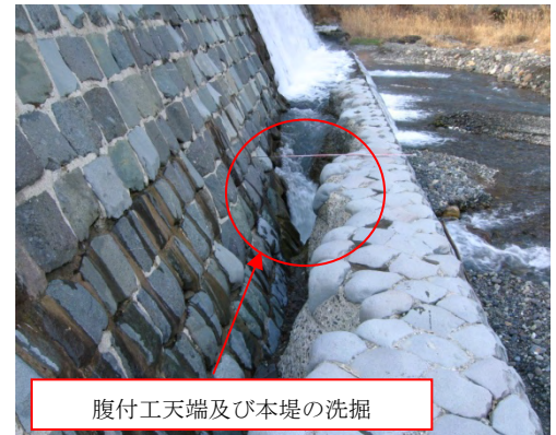
写真 4-1 腹付工（後施工）の損傷状況
